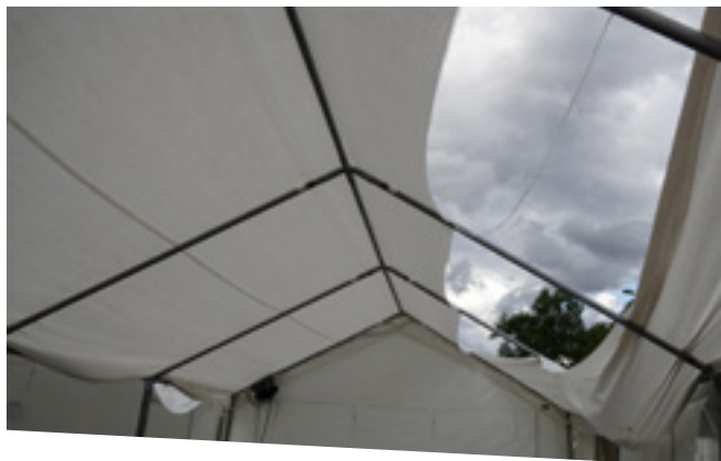
Ein echter Dachschaden
